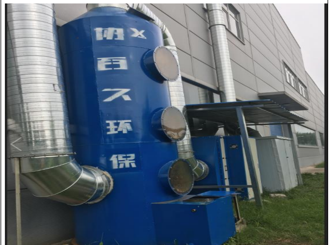
废气处理设施
