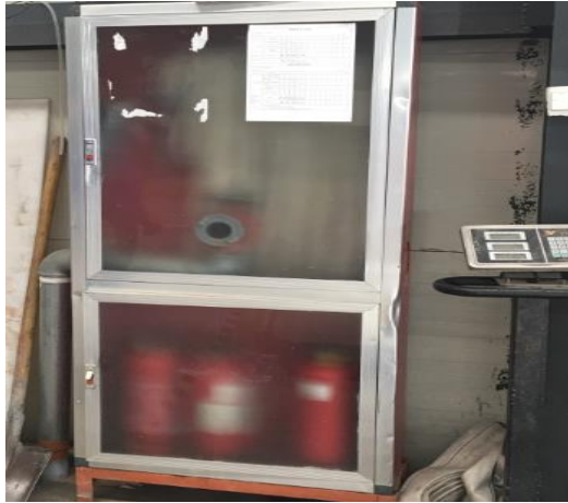
消防栓灭火器
