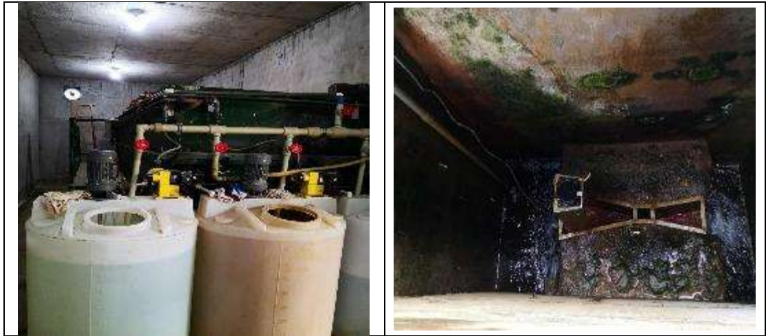
图 1 污水处理设备
